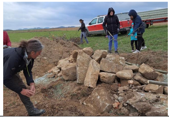
Eine Voraussetzung für die Anlage eines Reptilienbiotops ist die Verfügbarkeit von Material wie Steinen und Totholz vor Ort. Der Antransport ist sehr kostenintensiv
